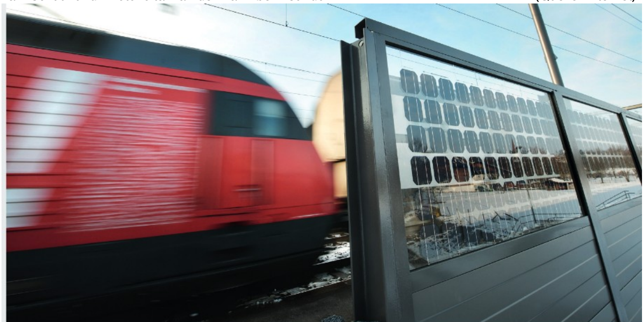
In Münsingen realisiert: die weltweit erste bifaciale Photovoltaik-Schallschutzanlage entlang einer Bahnlinie.
